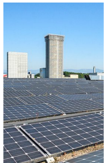
Solarenergie-Anlagen wie hier in der Buchmatt sind in Burgdorf weit verbreitet. Foto: F. Rothenbühler
